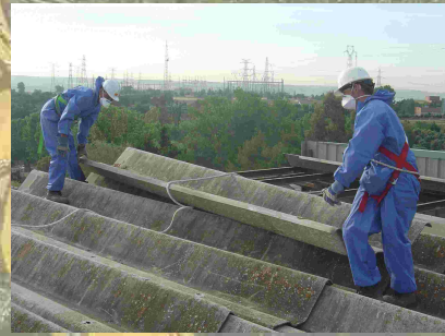
Amiantos y fibrocementos
